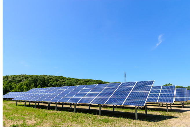
太陽光発電所
